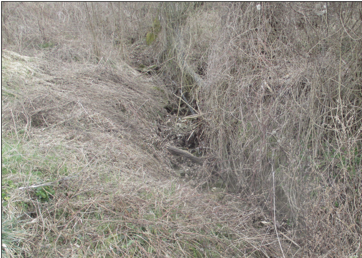
Figura 1: vegetazione ripariale infestante di ostacolo allo scorrimento delle acque
