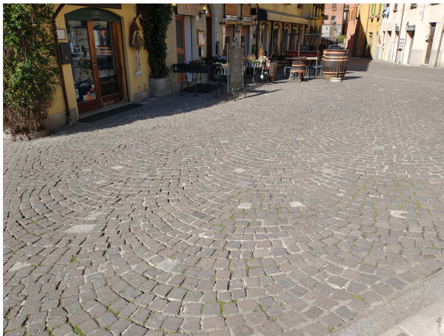
Figura 1-Porzione di pavimentazione per la quale si prevede il rifacimento utilizzando nuovi cubetti
