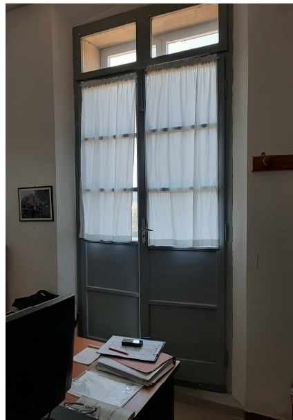
Figura 2-Porta finestra esistente ufficio messo
